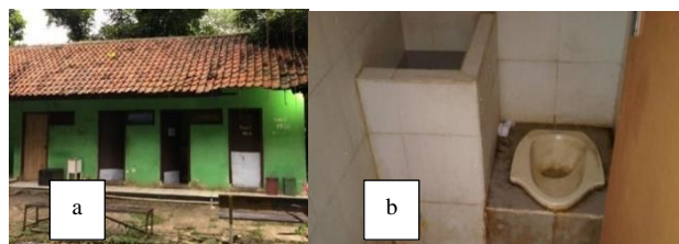
Gambar 2. Kondisi Eksisting Toilet Umum Hutan Kota Bekasi
