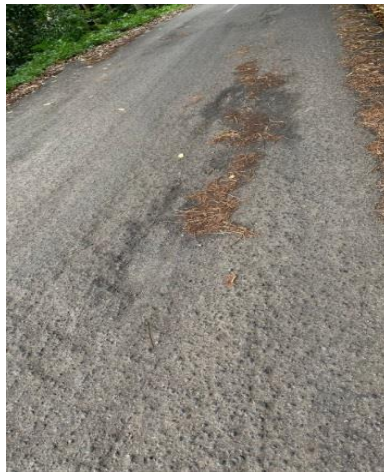
Gambar 1. Kondisi Kualitas Jalan Ruas Jalan Cicadas-Pasirpeuteuy Tahun 2024
