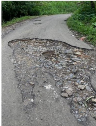
Gambar 2. Kondisi Ruas Jalan Pasirpeuteuy-Kaduengang Tahun 2024
