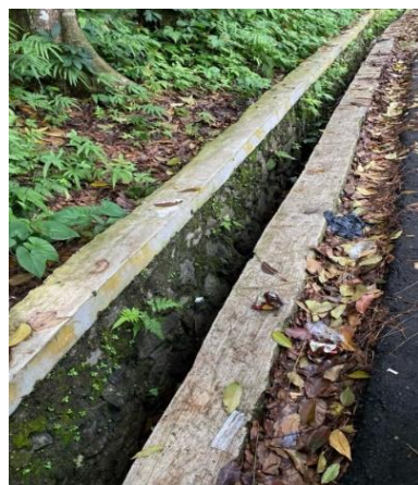
Gambar 2. Kondisi Drainase Ruas Jalan Cicadas-Pasirpeuteuy
