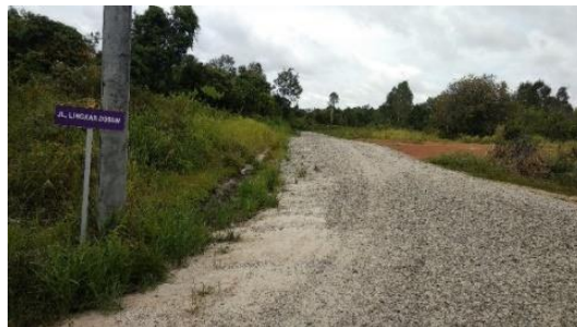
Gambar 16. Kondisi Bagian Jalan yang Perlu Dilakukan Perbaikan Menggunakan Aspal
